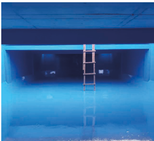
Serbatoio dell'acqua potabile, Oman: Multistrato: Sikafloor®-161, Sikagard® PW di colore blu.
